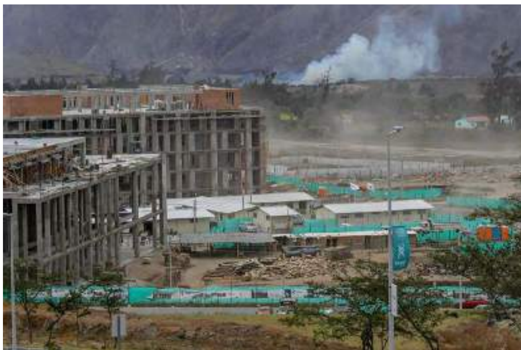
Figura 3: Estado de los edificios abandonados Yachay
